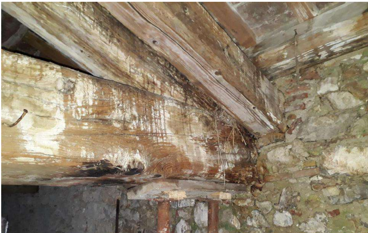
Figura 6: particolare appoggio capriata ammalorata
