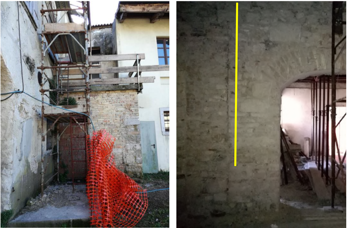
Figura 8 Corpi aggiunti angolo NORDOVEST ed evidenza di scollegamento tra le murature.
