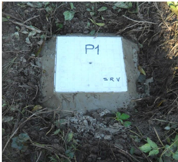
Pozzetto piezometro P1
